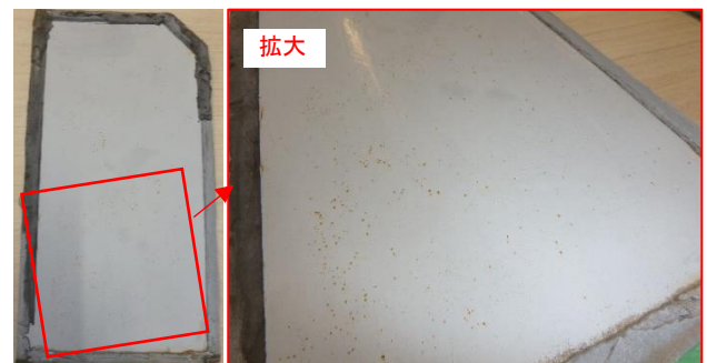
図-3 錆の状況（水系①A社の例）
