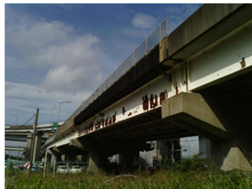
図1 塗膜剥離の例
