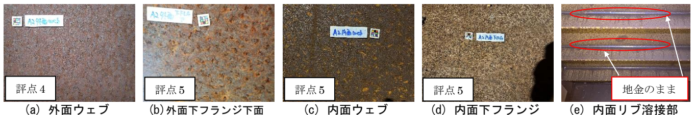
写真-3 さびの生成状況
