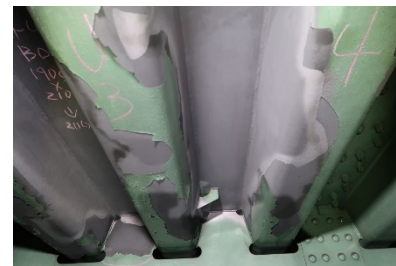
写真-1 鋼床版裏面の剥離状況
