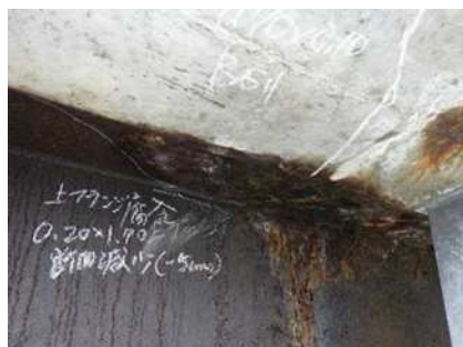
図-1 床版漏水により上フランジに発生した重度腐食
