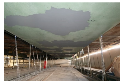
写真-2 下フランジの剥離状況
