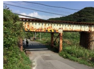
写真-3 桁腐食状況 (C橋)
