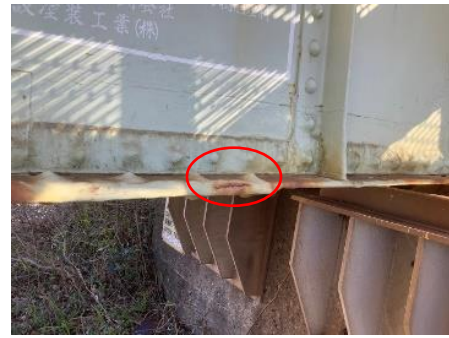
写真-4 パッチひび割れ状況
