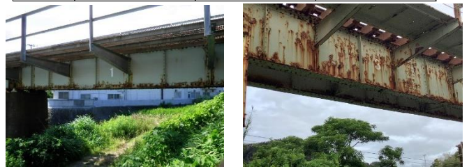
写真-1 桁腐食状況 (A橋) 写真-2 桁腐食状況 (B橋)
