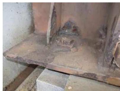
(a) 補修塗装後の再劣化
