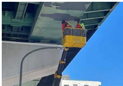
写真-1 塗膜の剥離状況 (2022年1月撮影)
